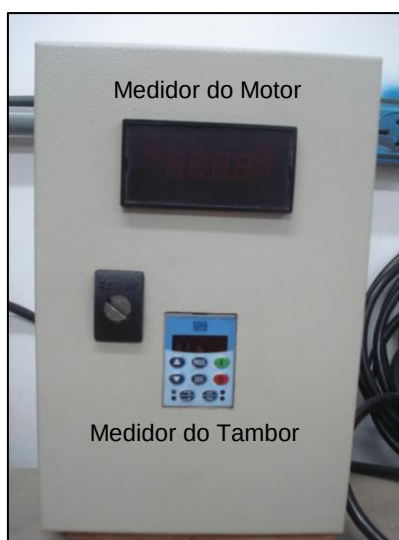
Figura 5 – Painel de Controle (Fonte: Autor)
