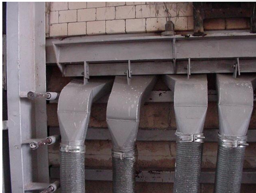
Instalação com falta de manutenção comprometendo funcionamento correto da ventilação
